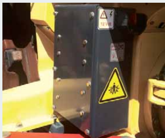
Доступ на уровне земли к аккумуляторному отсеку и к главному выключателю.
