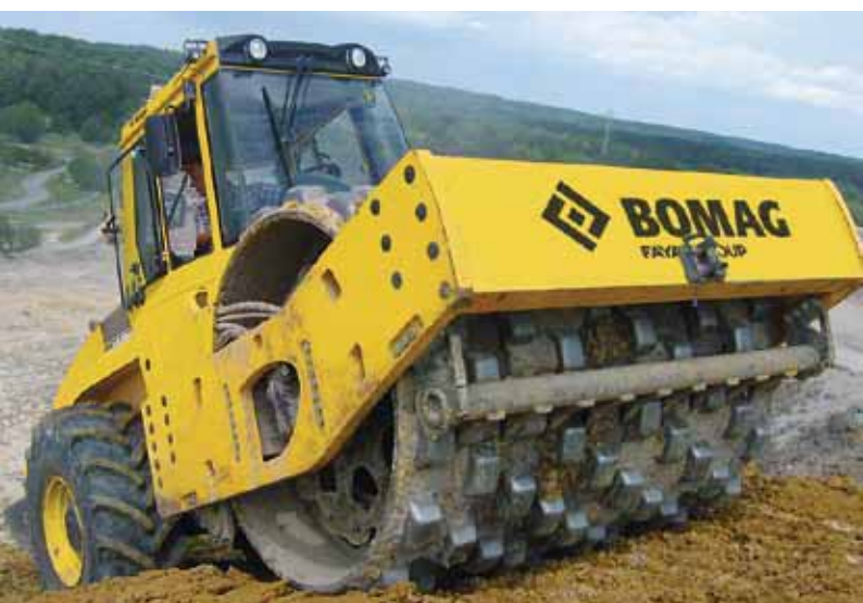
Привод DH - способность преодоления подъемов до 63%. Здесь показан BW 219 PDH-4 на сооружении плотины.
